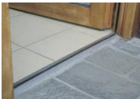
Eine solche Türschwelle fast ohne Höhenunterschied funktioniert bei Terrassentüren nur bei ausgeprägtem baulichen/konstruktivem Schutz
