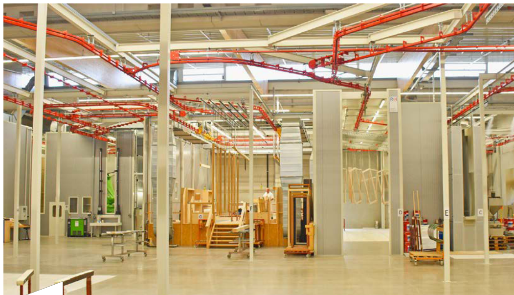
Das Besondere an dieser Lackieranlage ist der sehr hohe Grad der Automatisierung: Die komplette Lackierstraße wird über einen Leitreechner gesteuert. Mitarbeiter geben bereits bei der Teileaufgabe den Barcode mit, der den Lackierparametersatz für den Roboter und die Decklackfarbe enthält.
