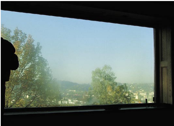
Bild 3: Eine vollflächige Kondensation im Scheibenzwischenraum der Isolierglaseinheit
