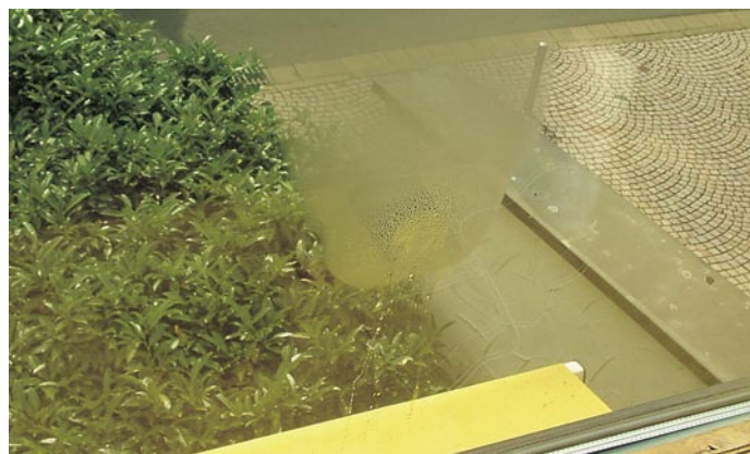
Bild 2: Im Bereich der Messmimik zeigen sich Kondensatrückstände
