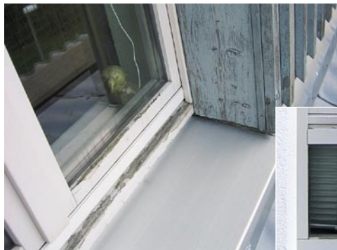
Bild oben: Schadstellen bei den weiß lasierten Fenstern in der Verbreterungsfassade, Südseite
