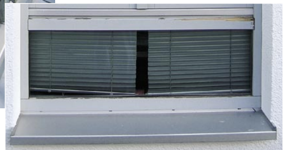
Bild unten: Zerstörte Farbschicht an dem deckend grau lackiertem Fenster
