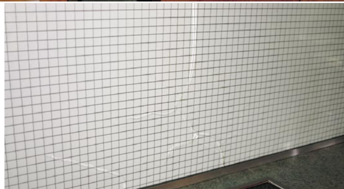
Bild 2: Deutlich zu sehen sind die Glassprünge
