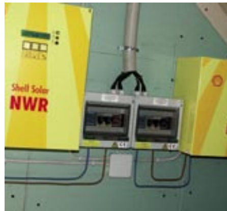
Die elektrische Verschaltung sollte durch ein Elektro-Fachunternehmen erfolgen
