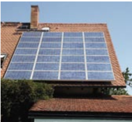
Gesamtansicht einer PV-Anlage mit 3 kWp
