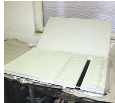
Bild oben und unten: Ein beschädigtes und geöffnetes Fassadenelement
