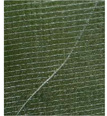
Ansicht einer der gesprungenen Drahtglasscheiben
