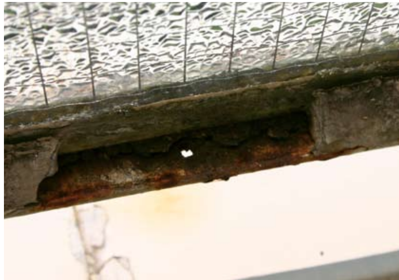
Ansicht von herausgebrochenem Spritzkitt
