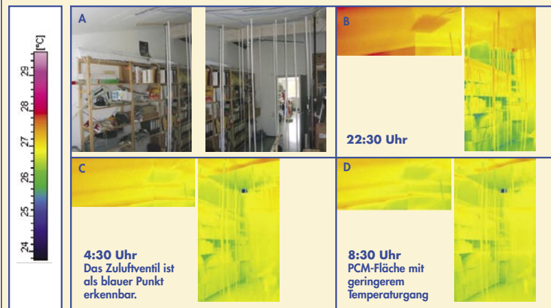
Abb 4: A Raum im Dachgeschoss; B-D Die Thermographieaufnahmen entsprechen in etwa der dargestellten Ansicht A. B Die Raumdecke hat sich auf Temperaturen zwischen 27 und 28°C aufgewärmt. In der Decke ist eine leicht dunklere d. h. wärmere Fläche zu erkennen. Dort ist ein konventionelles Gipskartonstück (Referenz) eingebaut.
