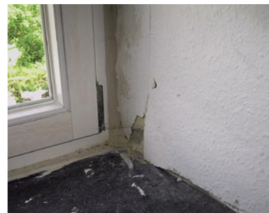
Unsaubere Putzfugen. So eine Arbeit sollte kein Fachbetrieb hinterlassen
