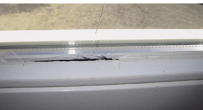
Ausgangslage war eine gerissene innere Scheibe der Isolierverglasung
