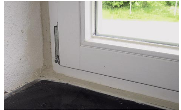
Fuge zwischen Fensterbank und Blendrahmen. Was fehlt ist die Wasserhohle
