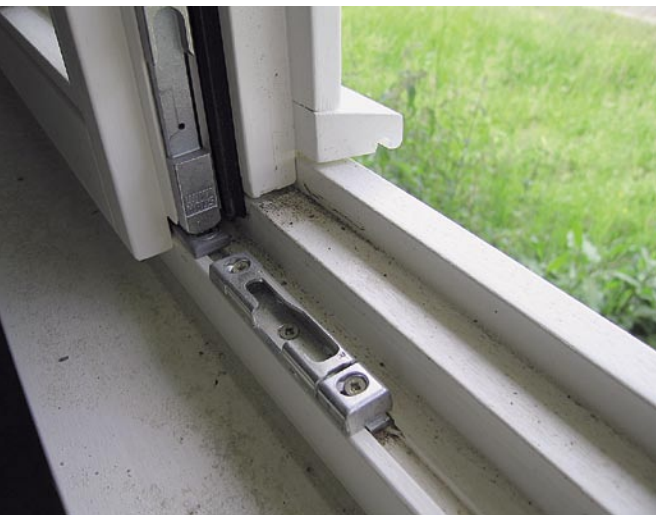
Kantenflächen unter dem Wasserschenkel sind nicht schräg
