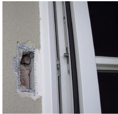
Nicht fachgerecht ausgeführte Dichtungsmaßnahmen
