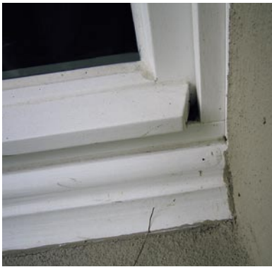
Schräg geschnittene Wasserschenkel und die Fuge liegt frei
