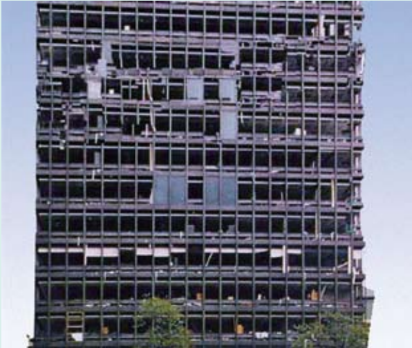
Zerstörte Fenster in einem Gebäude
