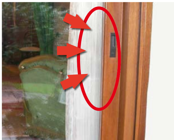
Schädigungen auf der Glasaußenseite im Griffbereich
