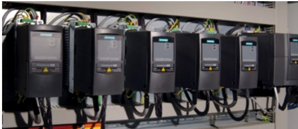
Drehzahlgeregelte Förderpumpen mit Leistungen bis zu 4 kW werden über Umrichter der Baureihe „Micromaster 4“ betrieben und sind über das Profisafe-Profil sicher abschaltbar
