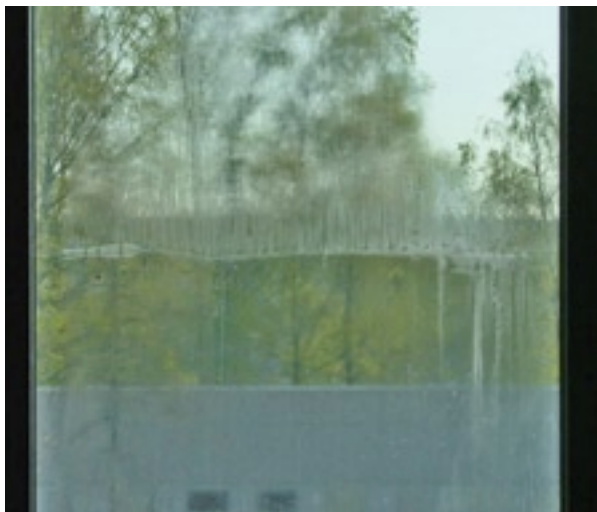
Bild 3: Horizontaler Sprung der mittleren Isolierglasscheibe
