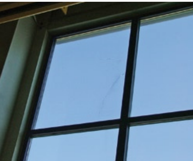
Bild 2: Beinahe rechtwinklig unter der rechten Glashalteleiste austretender Glassprung
