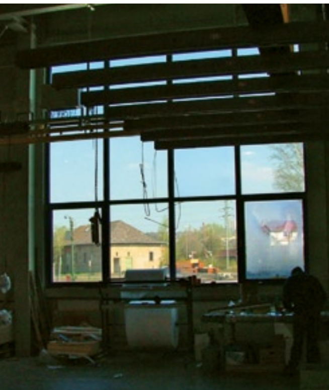
Bild 1: Bearbeitungs- und Lagerbereiche vor gesprungener Isolierverglasung
