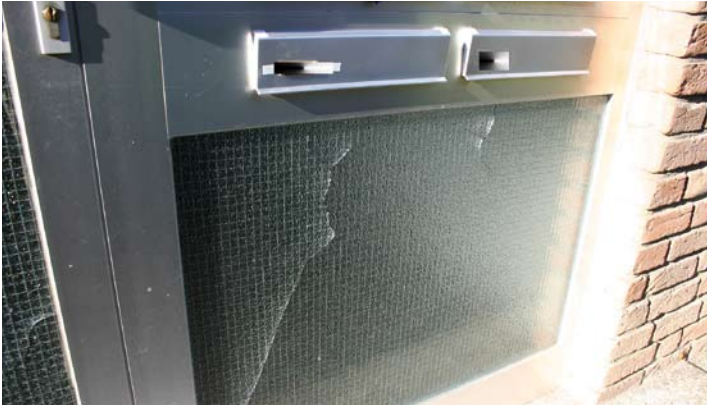
Bild 3: Ansicht von Glassprüngen
