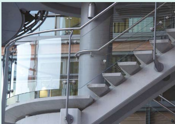
Wegen der gebogenen Scheiben dieser punktgehaltenen Absturz-sicherung reicht hier die Freistellung nicht aus
