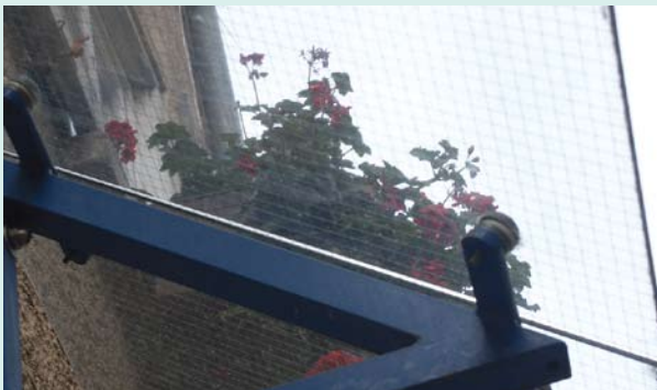
Ein derartiger Einbau von Drahtglas hat zu keiner Zeit einem Regelwerk entsprochen
