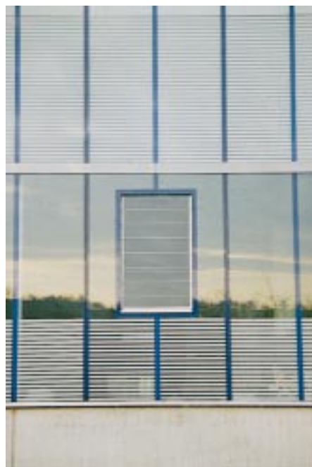
Das Lamellen-Lüftungs-System im eigenen Werk Foto: BGT Bischoff
