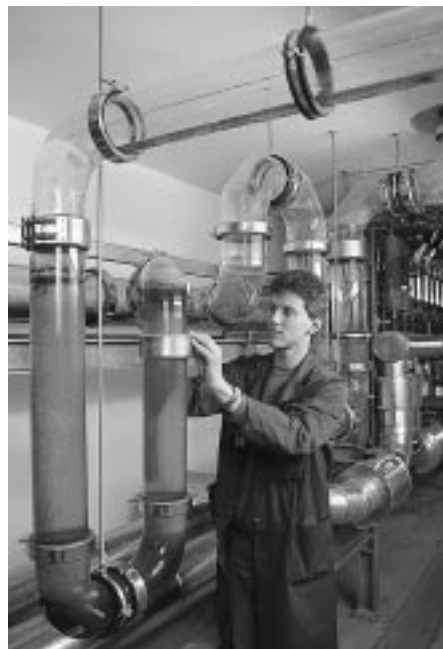
Abwasserleitungen im Flughafen-gebäude München
