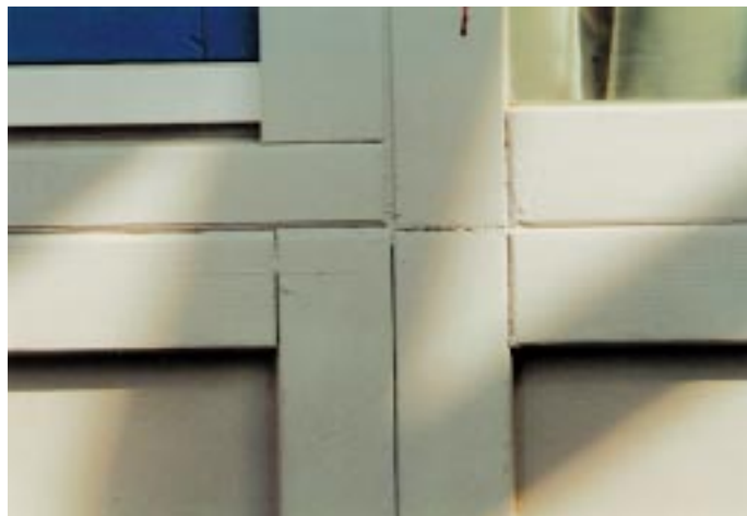
Unzureichende Schlagregendichtigkeit und erhöhte Fugendurchlässigkeit ...
