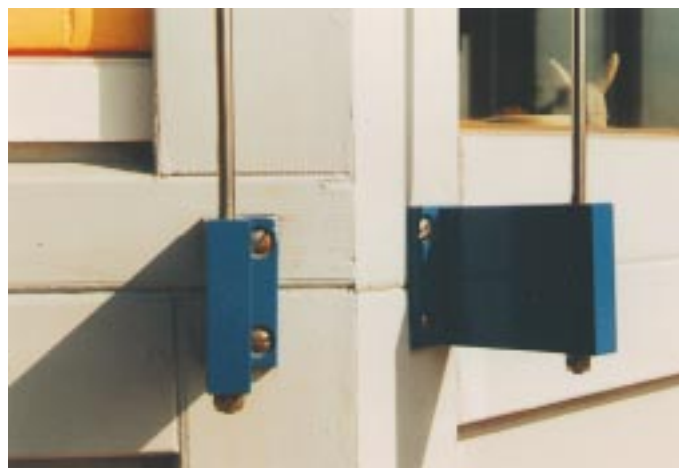
... sind die Folgen mangelnder Kenntnis elementarer Konstruktionsdetails Fotos: Achenbach
