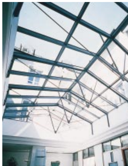
Bild 6: Brandschutz-Dachverglasung in F 30/G 30-Ausführung in einem Münchener Bankhaus aufgrund einer Innenhofbebauung
