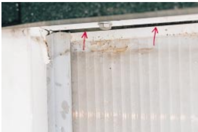
Bild 3: Durch diesen Hohlraum vermag Wasser einzudringen
