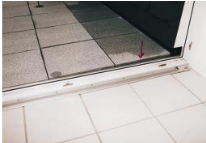
Bild 2: Der Terrassenboden ist höher als das untere Blendrahmenstück der Tür
