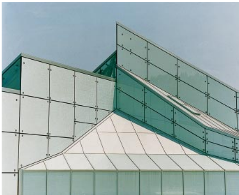
Die Fassade des Schönbühl-Centers in Luzern wurde 1992 auf der Südseite mit lichtstreuendem Isolierglas „Okalux“ verglast; obwohl die Isolierglasscheiben teilweise Maße von 200 \times 250 cm hatten und nur über vier Lochbohrungen gehalten wurden, reichte für die innere ESG-Scheibe eine Glasdicke von 6 mm aus
