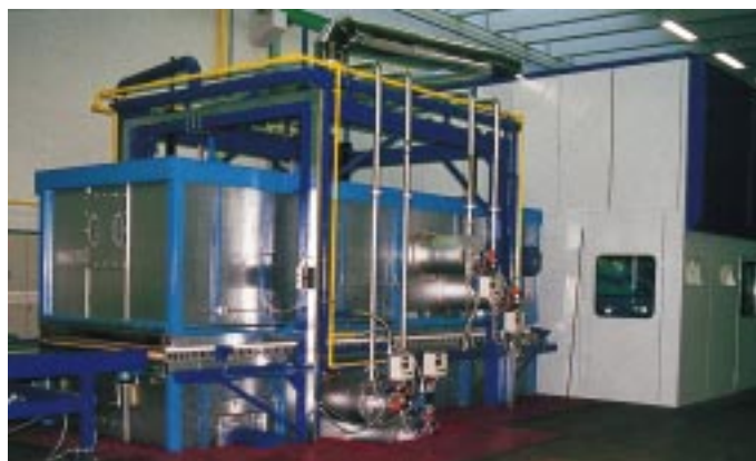
Blick auf das Herzstück der Glafurit-Hochkonvektionsanlage, der gasbeheizte Ofen Fotos: Steindl
