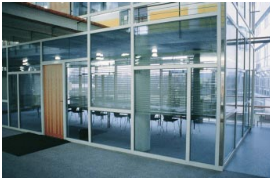
F30-Trennwände mit „Contraflam“ in einer Besprechungzone
