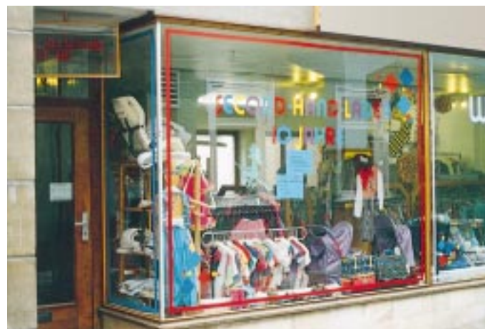
Gerade ältere Schaufenster bedürfen ständiger Kontrolle und Unterhaltung Foto und Skizze: Schultes
