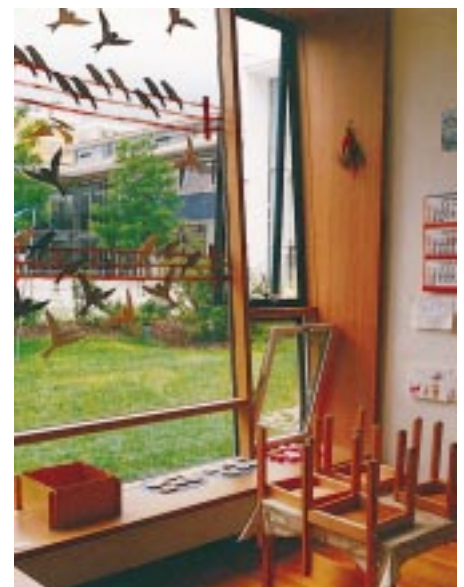
Innenglasflächen, die zwar über eine ausreichend breite Fensterbank geschützt werden, jedoch wurde die Mindesthöhe nicht eingehalten
