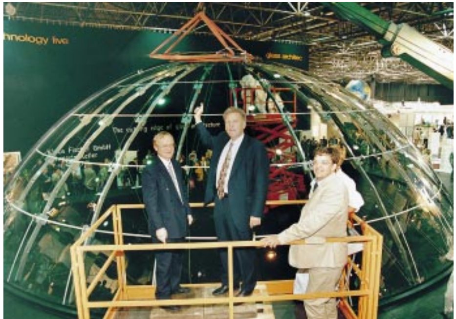
NRW-Bauminister Dr. Michael Vesper eröffnet die Sonderausstellung „Glass technology live“ in Halle 9 durch symbolische Anweisung zur Montage der letzten Glasscheibe an der 20-m-Halbkugel aus Glas
