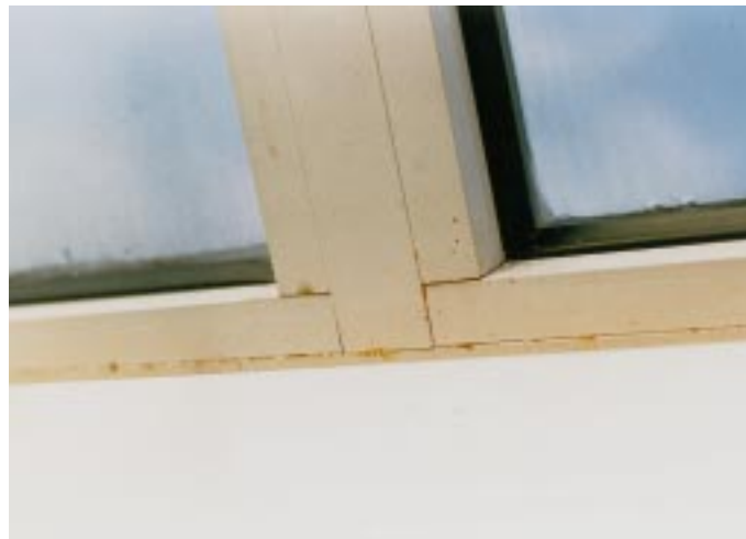
Spuren des eindringenden Wassers an den Glasleisten
