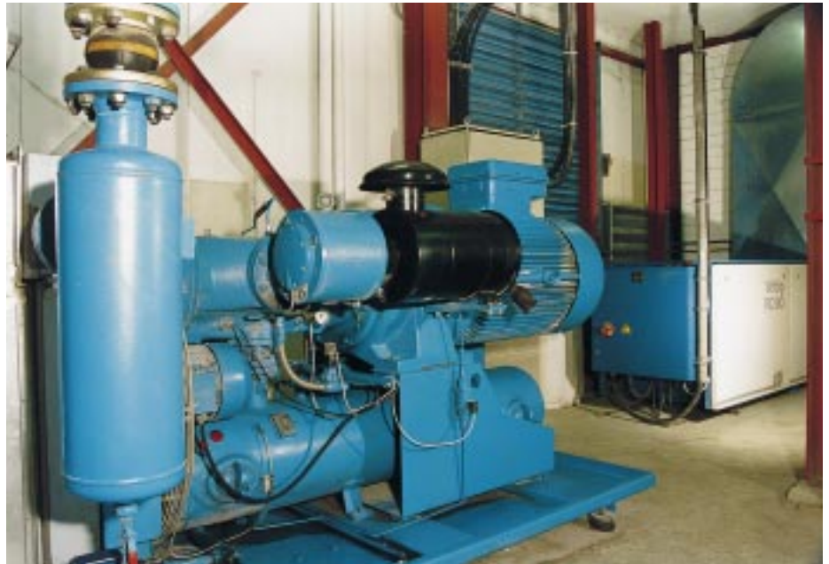
Druckluftstation mit Wittig-Rotationsverdichtern Typ „ROL 80“ und „ROL 170“
