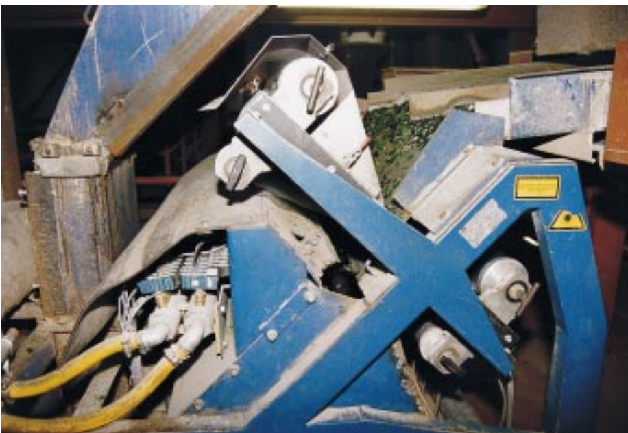
Altglas-Recyclinganlage mit Druckluftverbraucher zur Sortierung
