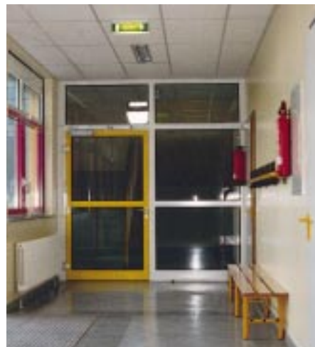
„Pyranova“-Brandschutzglas F 30 im „Jansen-Janisol“-Türsystem als Raumabschluß zwischen Treppenhaus und Flur eines Schulzentrums in Süddeutschland
