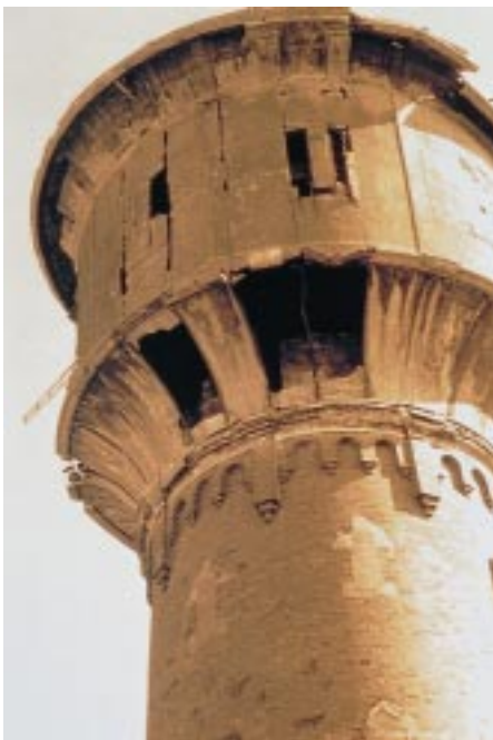
Ein trauriger Anblick: Die Kuppel des Wasserturms von Schwedt war eingefallen, der Putz abgebröckelt, Fenster und Türen waren zugemauert
