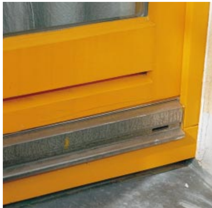
Nachgefallene Reparaturstelle an einem Türunterstück
