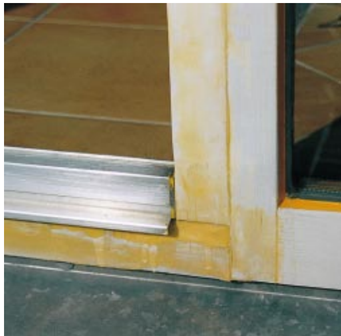
Erheblich geschädigtes Fenster
