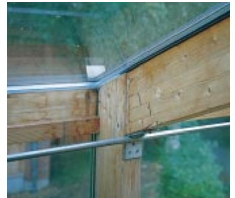
Bild 12: Nachträgliche Silikondichtungen und Flecken auf der Holzkonstruktion offenbaren Konstruktions- und Formmängel
