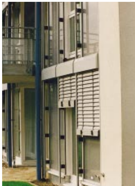
Die TWD- und Fensterflächen sind mit Außenraffstores beschattet. So bleibt die „solare Wandheizung“ im Sommer „ausgeschaltet“
