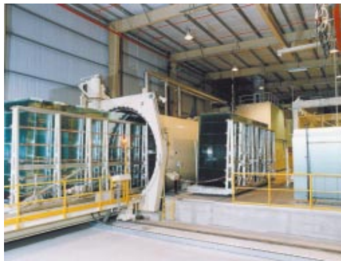
Im Autoklaven erfolgt die Verbindung zwischen den Glasscheiben und den dazwischen liegenden Folien – diese Anlage ist für Scheiben bis zu 6 x 3,21 m ausgelegt
