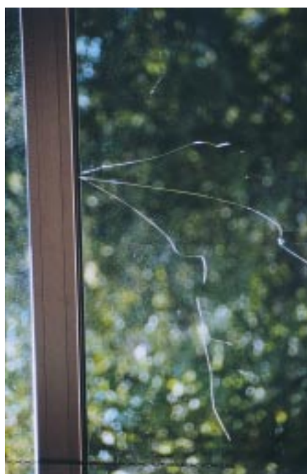
Bild 15: Starker thermischer Sprung, durch dunkles Poster direkt hinter der unbeschichteten Standard-Isolierglasscheibe verursacht; Nr. Period.-System: 2 B, Gruppen-Nr. 003
