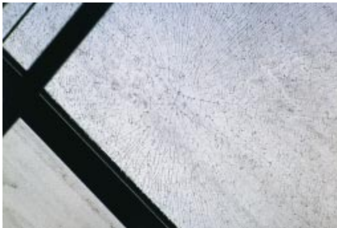
Bild 18: Nickel-sulfidbruch, Isolier-glas aus 2 x ESG im Gewächshaus Überkopf, gesprun-gene Außenscheibe liegt auf Innen-scheibe auf, drei Monate nach Ein-bau; Nr. Period.-Sys-tem: 2 A, Grup-pen-Nr. 008
