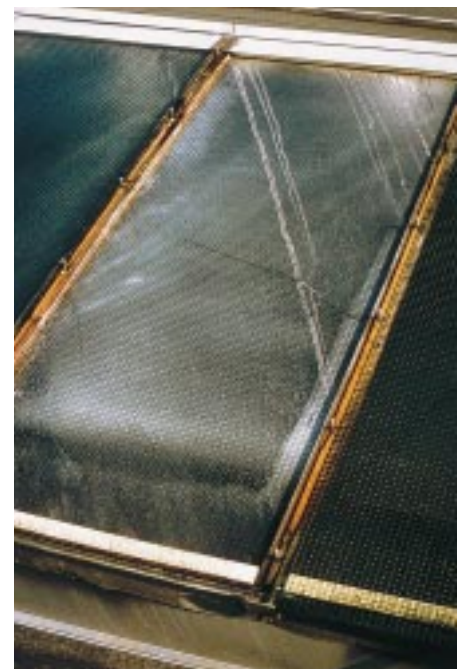
Bild 12: Drahtglas mit thermischem Normalsprung durch großen Glaseinstand, Gesamtansicht; Nr. Period.-System: 1 B; Gruppen-Nr. 001
