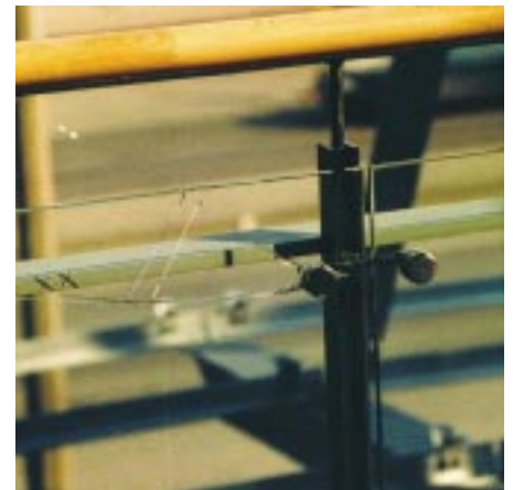
Bild 24: Punktuelle Belastung durch Klemmbeschlag bei punktgehaltenem VSG; Nr. Period.-System: 1 C, Gruppen-Nr. 016
