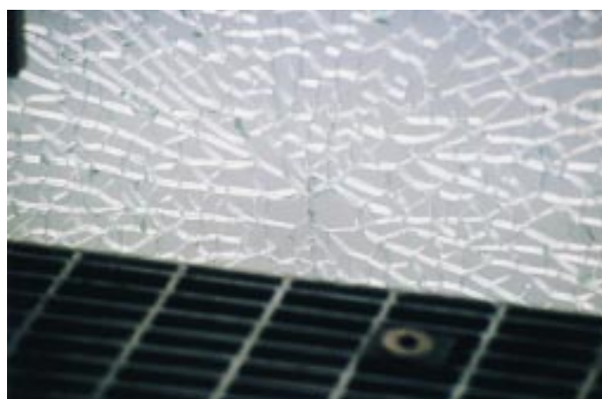
Bild 17: Nickel-sulfidbruch, Sontanbruch bei Brüstungsscheibe aus VSG aus 2 x ESG ca. drei Monate nach Einbau; Nr. Period.-System: 2 A, Gruppennummer 008
