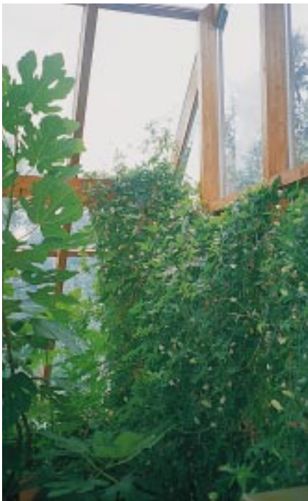
Dichte Begrünung verhindert Hinterlüftung und birgt erhöhtes Feuchteschadensrisiko
