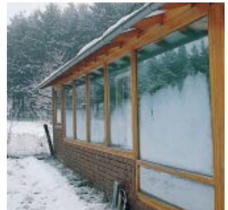
Thermisch mangelhafte Konstruktionen und falsche Nutzung machen den Wintergarten zum Eishaus.
