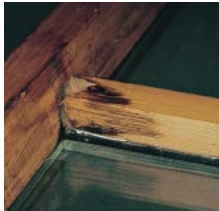
Stehendes Tauwasser verursacht Holzschäden am Glasstoß
