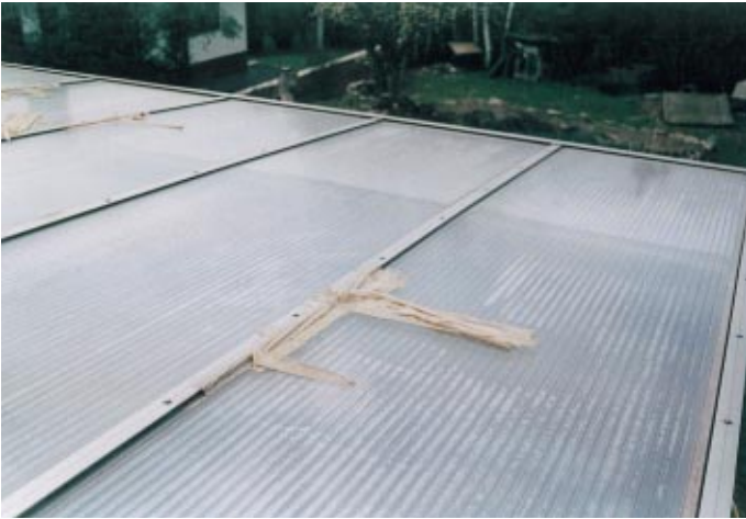
Bild 3: Die Mehrzahl der Risse geht von innen nach außen
