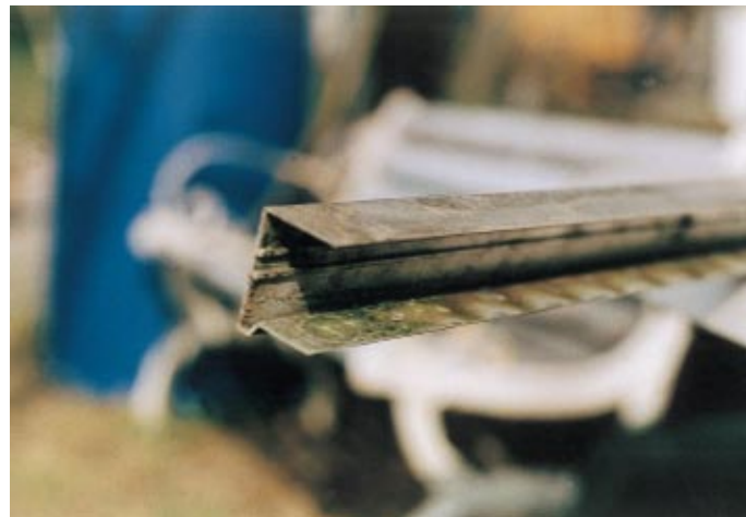
Bild 8: Die Konstruktion des Abschlußprofils eignet sich nicht für einen ordnungsgemäßen Ablauf des Kondenswassers
