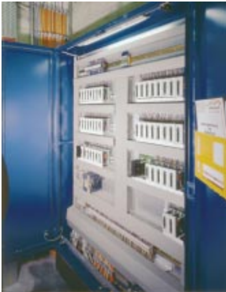
Steuerzentrale in Einschubtechnik
