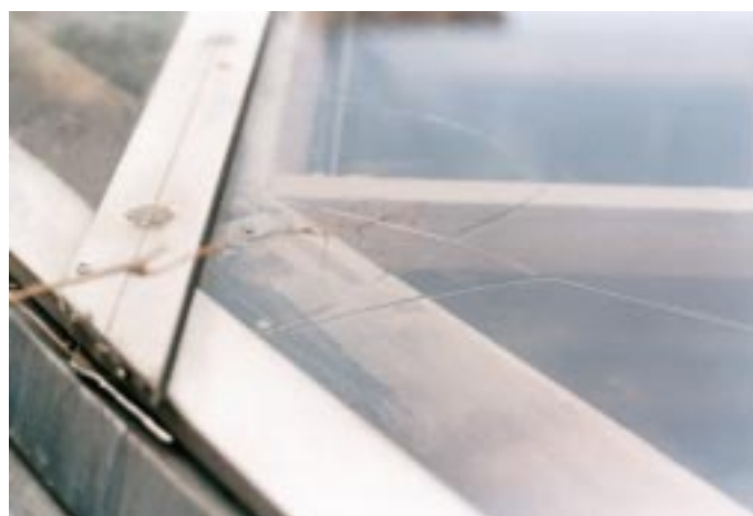
Bild 2: Nach Erneuerung ging die Scheibe ein zweites Mal zu Bruch
