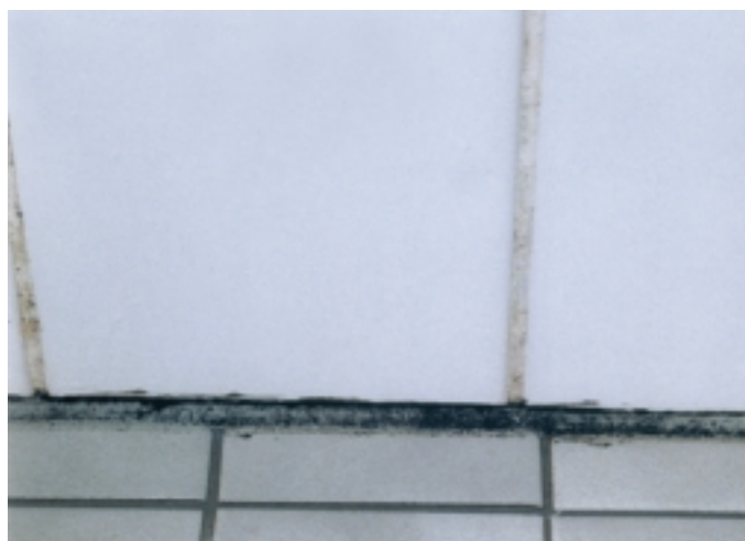
Bild 4: Stark von Schimmelpilz befallener Dichtstoff. Es handelt sich hier um einen als Rechteckfuge mit einer Mindestbreite 10 mm ausgebildeten Randanschluß Bodenbelag/Wandbekleidung aus keramischen Fliesen in einem großen, den ganzen Tag und das ganze Jahr benutzten Duschaum
