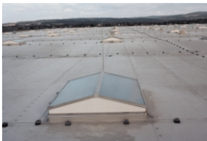
Blick auf die 72 geschlossenen RWA-Geräte im Norma-Logistikzentrum in Regenstau
