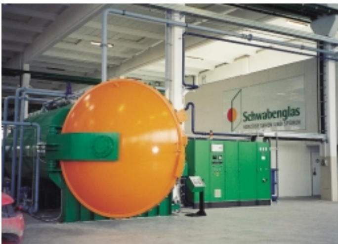
Schwabenglas mit neuer VSG-Linie der Firma Armatec und Autoklav Bild: Schwabenglas
