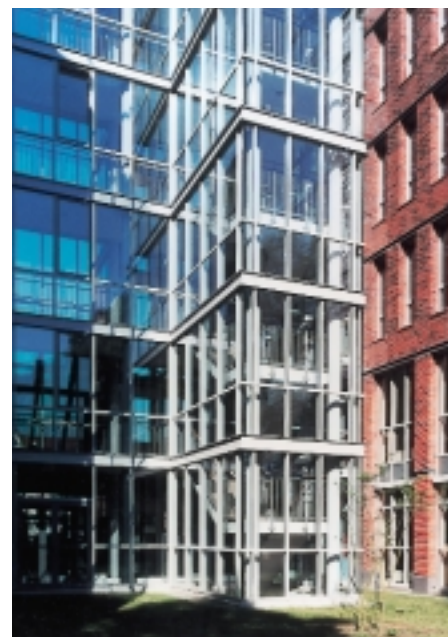
Bild 6: Brandschutz in den Lochfassaden: F 90 Pfosten-Riegelkonstruktion für EG und 1. OG, darüber Einzelfenster in einer F 90 Systemkonstruktion
