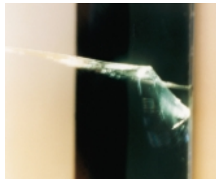
Bild 6: Der Anfang des waagerechten Risses war an der rechten Kante durch die Glasleiste verdeckt. Dieser Muschelbruch entstand ebenfalls durch eine Stoß- oder Schlagbelastung
