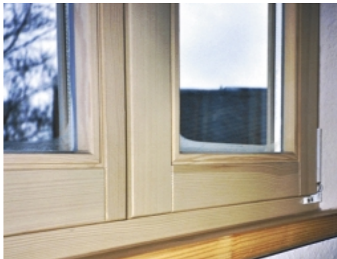
Bild 1: Kondensation an der kalten Kante eines Holzfensters mit Aluminium-Abstandhalter
