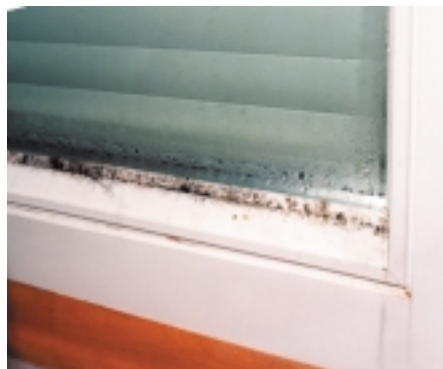
Bild 2: Starke Kondensation und Schimmelbildung an einem Holzfenster mit „Kalter Kante“
