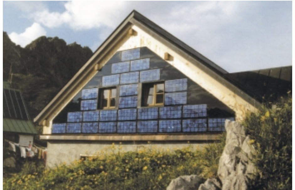
Extremtest für Photovoltaik-Anlage und Befestigungssystem an Deutschlands südlichster Berghütte
