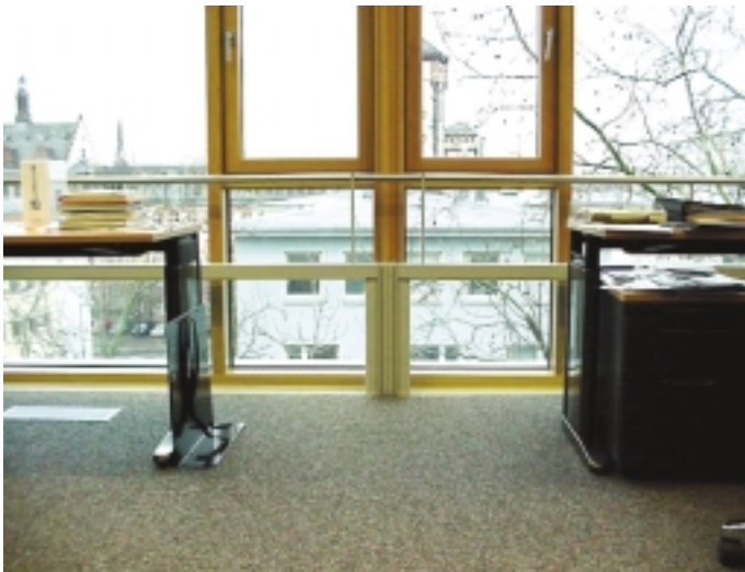
Bild 3: Blick auf den raumseitig angeordneten Teil der Feuerüberschlagsbrüstung mit absturzsicherndem Handlauf. „Paraflam F90“ verglast nach Zulassung Z-19.14-1173. Die Transparenz der geschoßhohen Verglasung bleibt vollständig erhalten, Glaslieferant Steindl Glas, Itter (Tirol)
