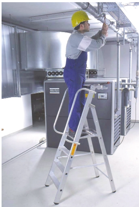
Arbeitsunfälle mit Gerüsten und Leitern sind die häufigste Ursache für Arbeitsunfälle
