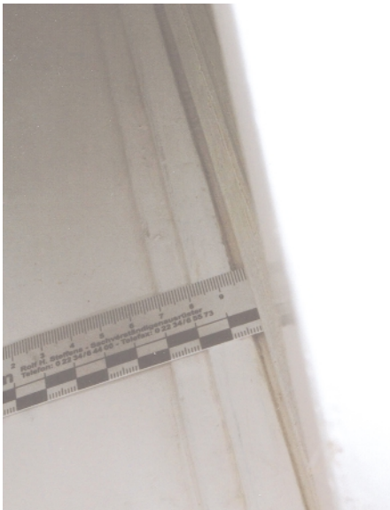
Bild 3: Die Anordnung von Heizelementen unterhalb alter Fenster ist eine zweifelhafte technische Lösung, weil dabei die feingliedrigen Holzprofile der inneren Flügelebene einem extremen Temperaturstreß unterliegen und so häufig erhöhte Undichtigkeiten auftreten
